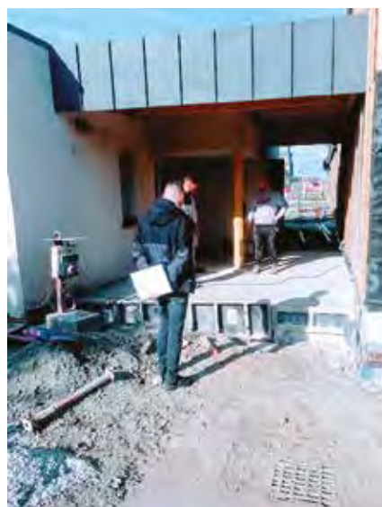
12 avril 2022 - Découpe dans le mur de l'école maternelle d'une nouvelle porte de liaison avec la nouvelle salle de motricité qui la reliera à l'accueil périscolaire.
